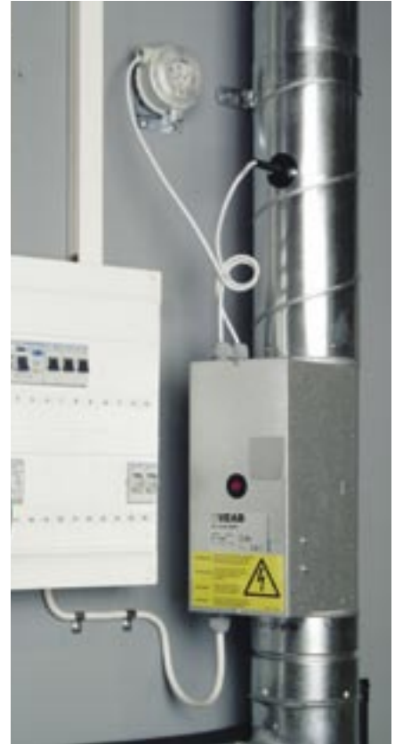
Ventilation med termostat, temperaturgivare, kanalvärmare och elcentral.
