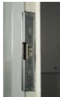
Elektroniskt lås till toalett- och tvätttrum som regleras utifrån.
