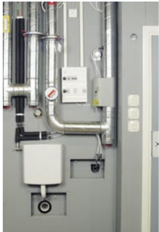
Nischvägg med bl a vatten, ventilation, spillåda, elcentral. WC-enheten utrustad med vakuumpolning
