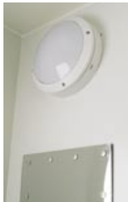
WC-belysning samt spegel i polycarbonat.
