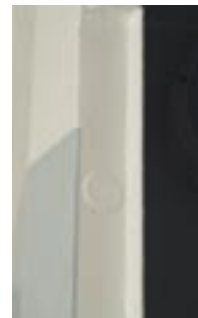
Magnetkontakt som signalerar ev uppbyggnad av dörr till toalett- och tvätttrum.
