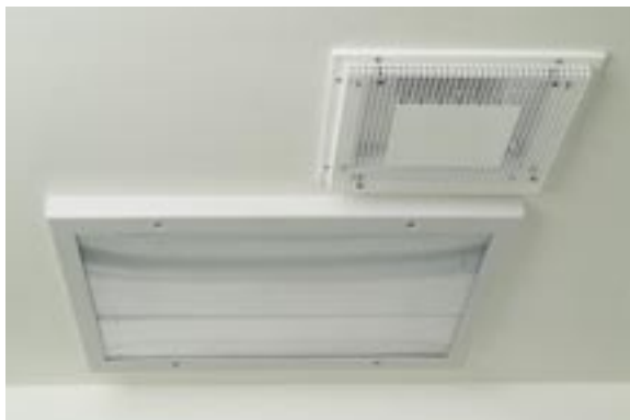
Ventilation och belysning med allmän-, nattbelysning och nödljus.
