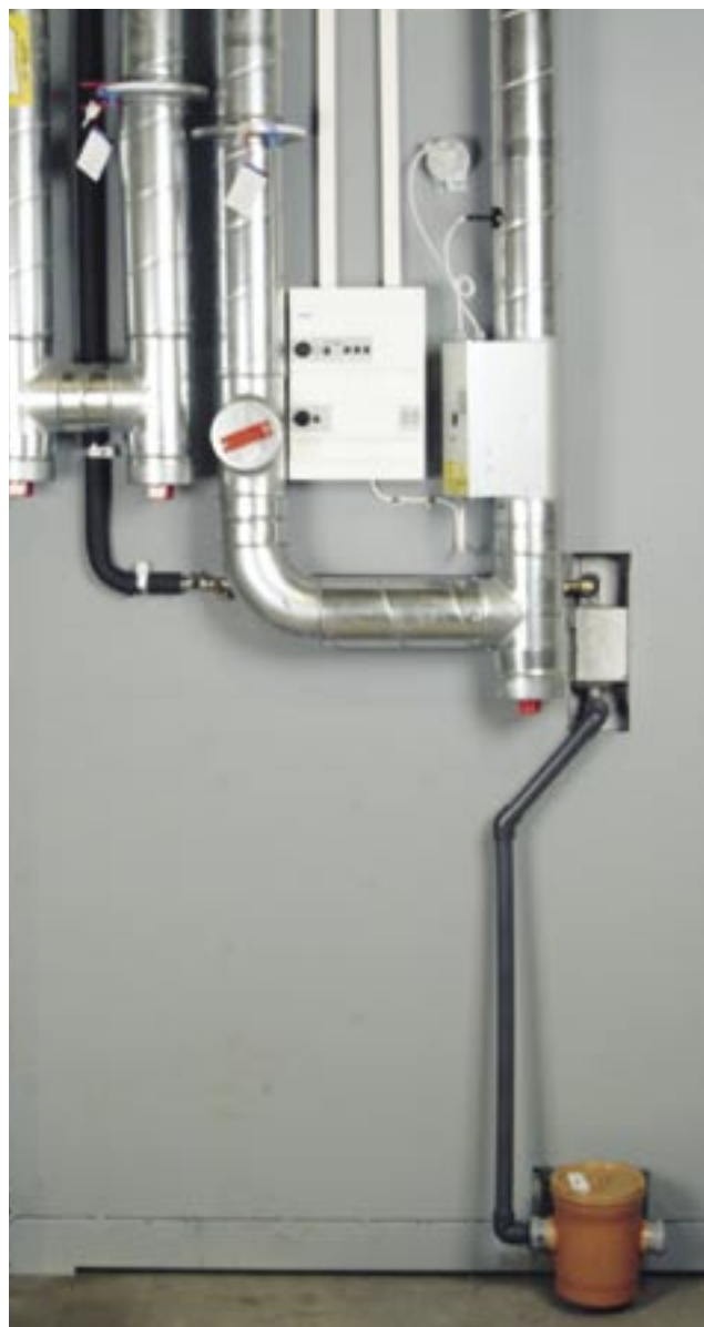
Nischfront med luftburen värme samt fönsterventilation. Kallvatten till dricksvattenpanel.
