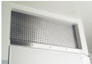
Ventilation till hygienrum.
