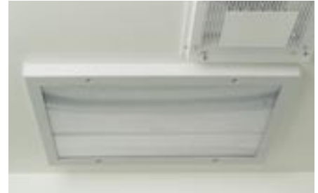
Ventilation och belysning med allmän-, nattbelysning och nödljus.
